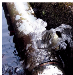
水道管からの水漏れ
