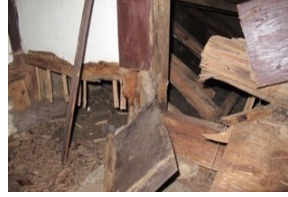
図 14. 台所柱の劣化
