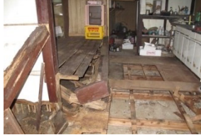
図 15. 台所床の劣化
