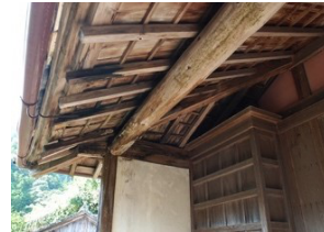
図 11. 腐敗した垂木 (南側)
