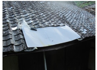
図 22. 母屋棟瓦の脱落
