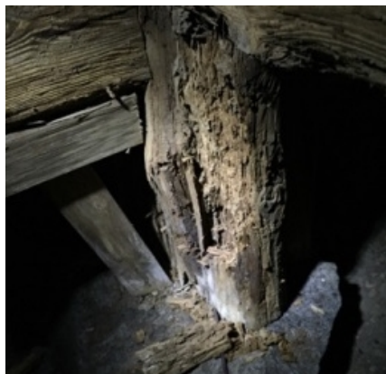
図3. シロアリによって劣化した基礎
