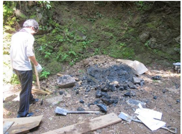
図6. 保護ブロック破壊の様子
