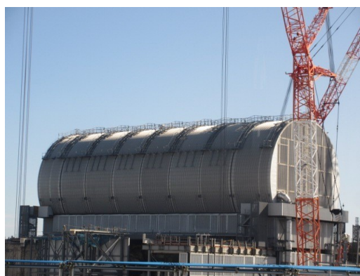
図2. 核燃料取り出し作業に向けてカバーが設置された3号機
