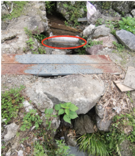
図2. 水力発電機の設置箇所
