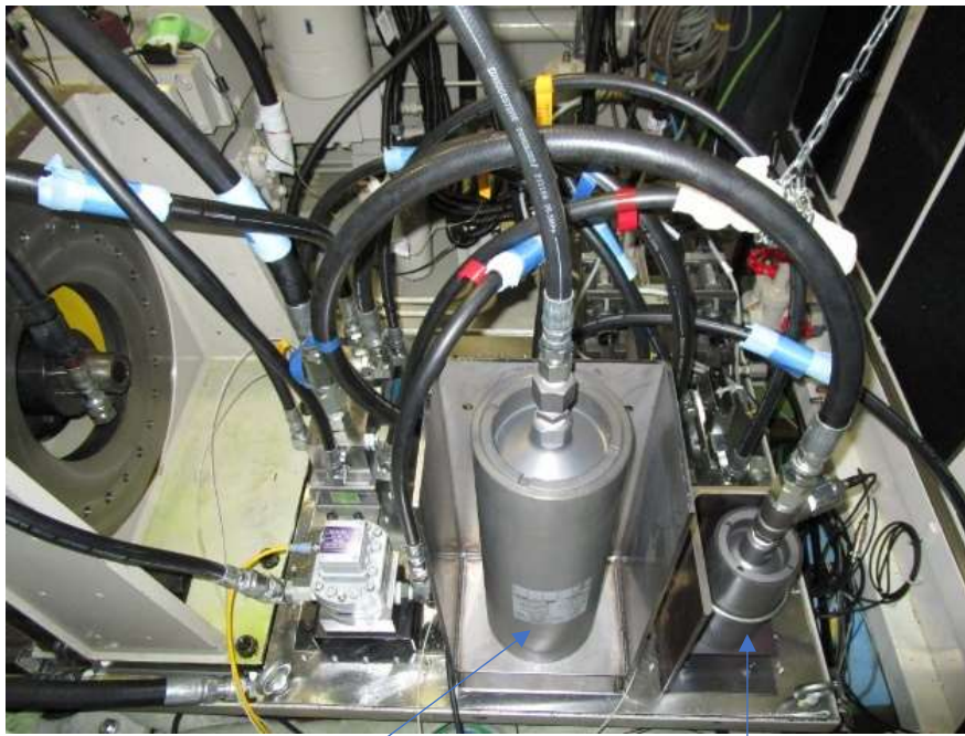
供給側のアキュムレータ 高圧側のアキュムレータ
