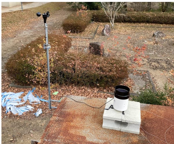
図2- 6. 気象観測センサ設置状況
