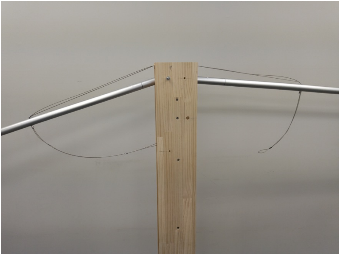
図 8-14 ワイヤーが伸びて桁の角度を維持できない状態
