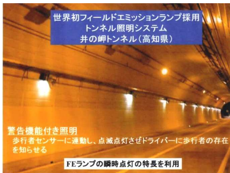
図 8-4. トンネル用警告照明
