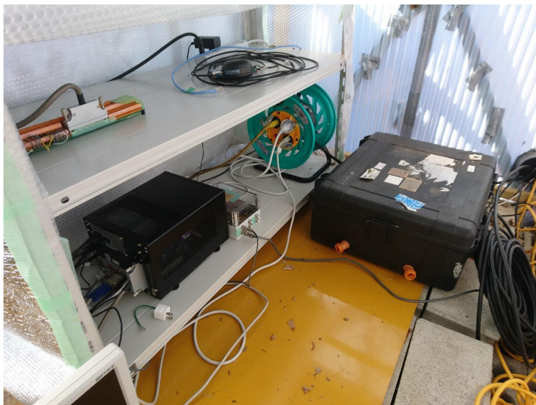
Fig. 3.4 センサ設置外観（高知工科大学観測小屋内）
