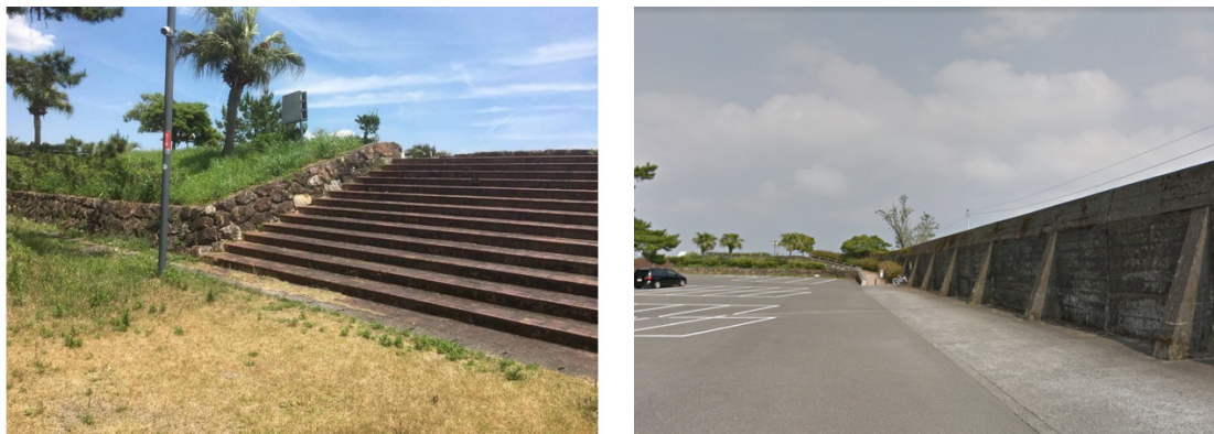
図 3-3 埋没した海岸保全施設（左）、南に位置する直立型の防潮堤（右）
